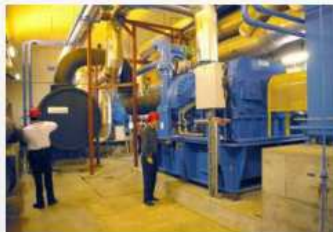
Stacja pomp ciepła "Skoyen Vest", Oslo, Norwegia
