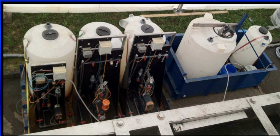
Zbiorniki chemikaliów, dozowniki
