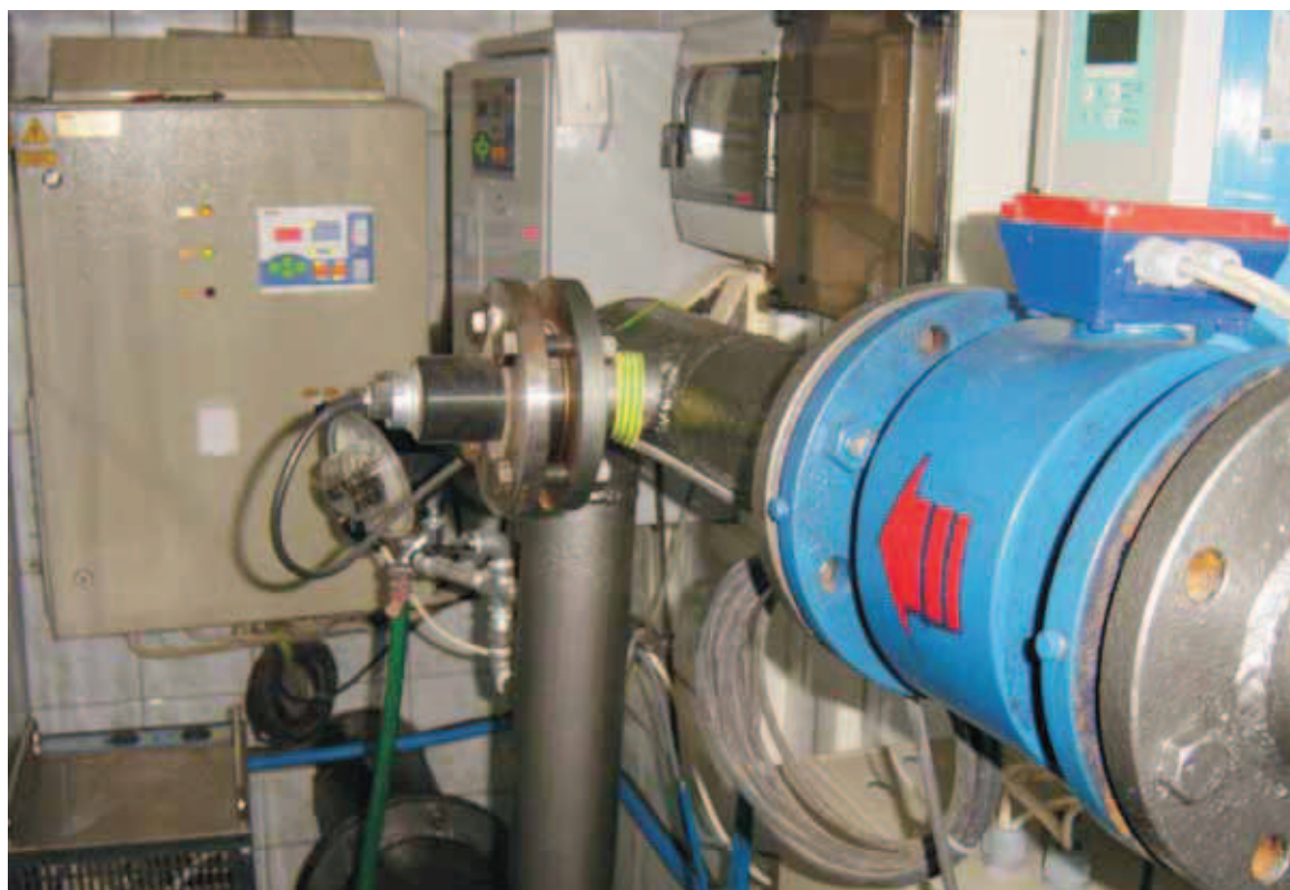
Fot. 5. Wyposażenie pompowni wodociągowej
